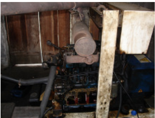
Generatore ad alimentazione diesel
